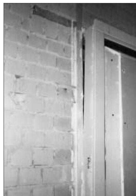
OP BOVENSTAANDE FOTO IS TE ZIEN DAT EEN HELE PUI UIT DE MUUR GEZOGEN IS. DIT IS HET GEVOLG VAN EEN IETS TE GROOT DRUKVERSCHIL OVER DEZE PUI.
